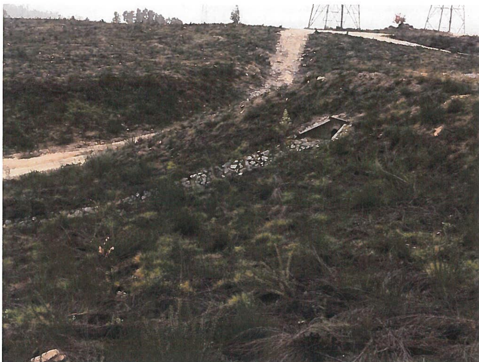
Fotografia 5 – Arranjo da linha de água
